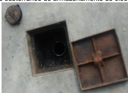
Figura 4. Tanque subterrâneo de armazenamento de óleo lubrificante usado
