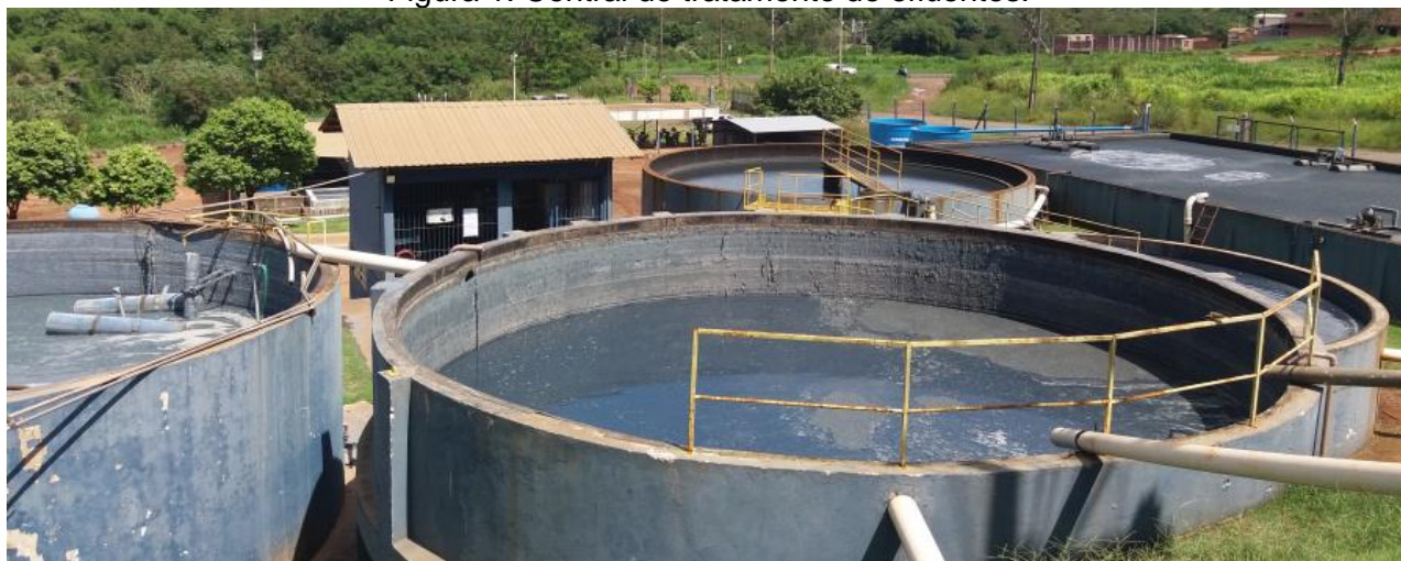
Figura 1: Central de tratamento de efluentes.
