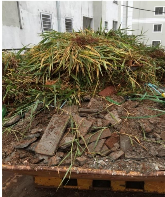
Figura 3: Mistura de resíduos observada na caçamba do CTR nº 34 Fonte: Autoria própria
